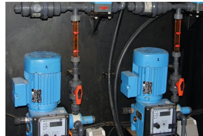
3. Dosierpumpen für das Phosphatfällmittel, 1 Pumpe dient als Ersatzpumpe.
