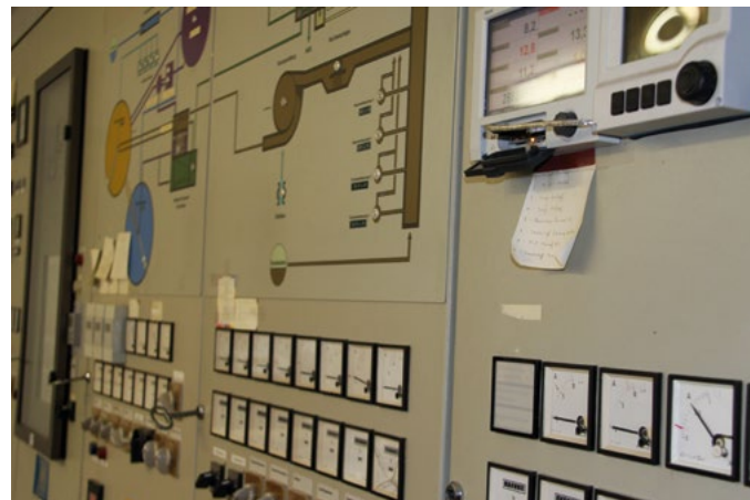
1. An der Schaltanlage sieht man teilweise rote Markierungen, die auf einen Blick verraten, ob es ein Problem gibt.
