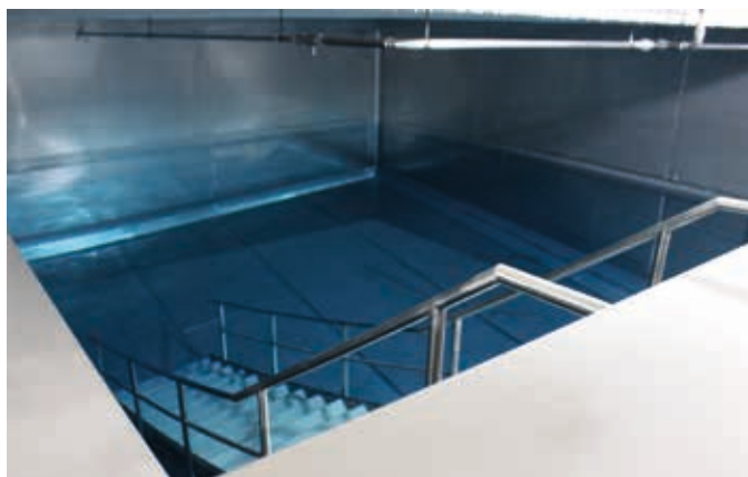
Der neue Hochbehälter
