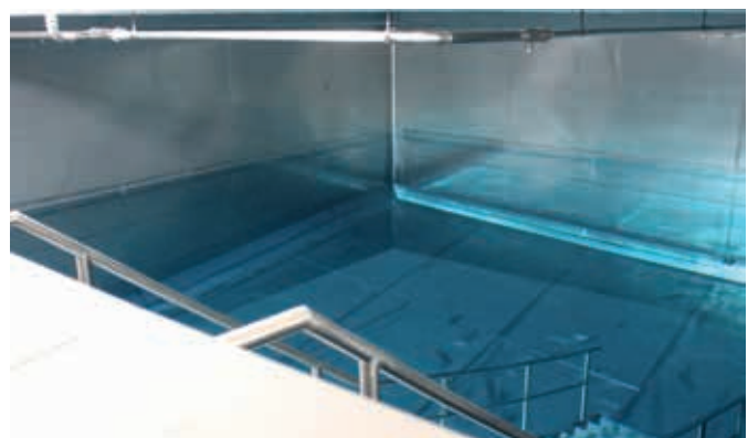
Einer der Hochbehälter, Fassungsvermögen 2 x 500 Kubikmeter.
