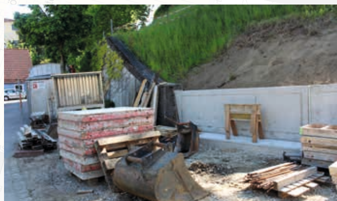
Die alte und die neue Mauer stoßen aufeinander.
